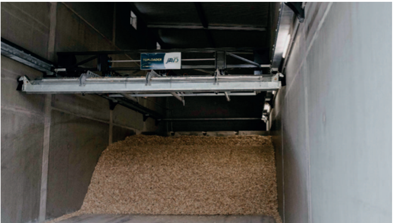
29: Brennstofflager mit Toploader-Technologie
