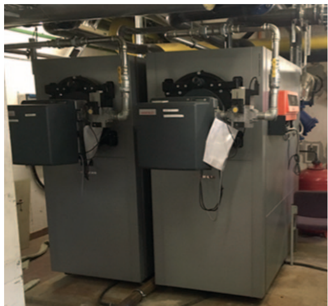
33: Zwei neue Brennkessel BHZ Marburg
