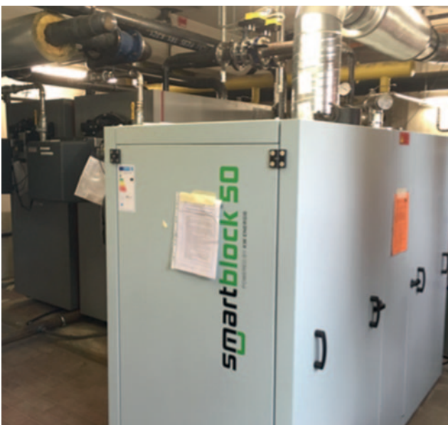
32: neues BHKW BHZ Marburg
