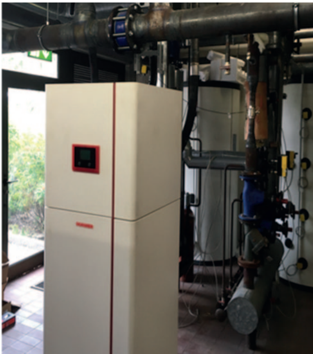
34: neue Luft-Wasser-Wärmepumpe BHZ Marburg
