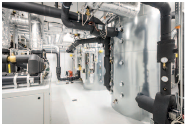
39: Technikraum der THM
