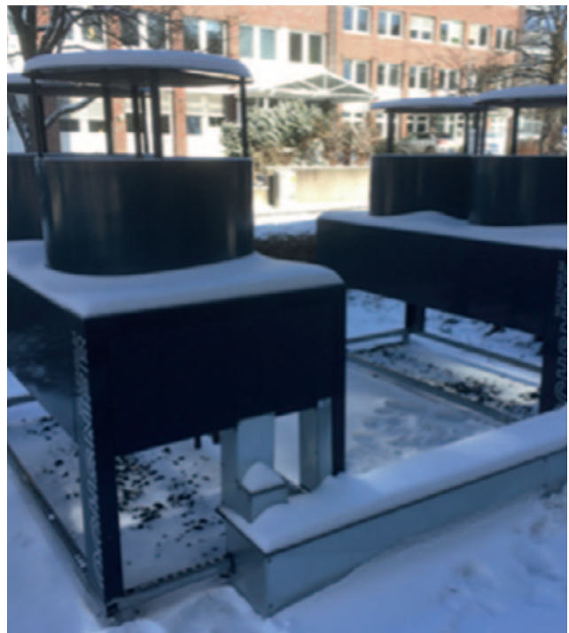
35: Splitverdampfer der Luft-Wasser-Wärmepumpe
