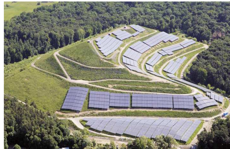
Quelle: House of clean energy - Photovoltaik Module auf dem ehemaligen Deponiegelände Grix in Offenbach
