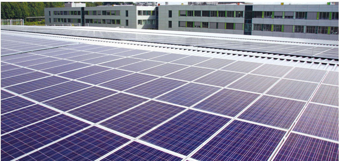
Photovoltaikanlage Philipps-Universität Marburg
