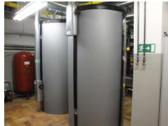
Pufferspeicher für BHKW
