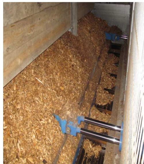
Entnahmekanal für Hackgut
